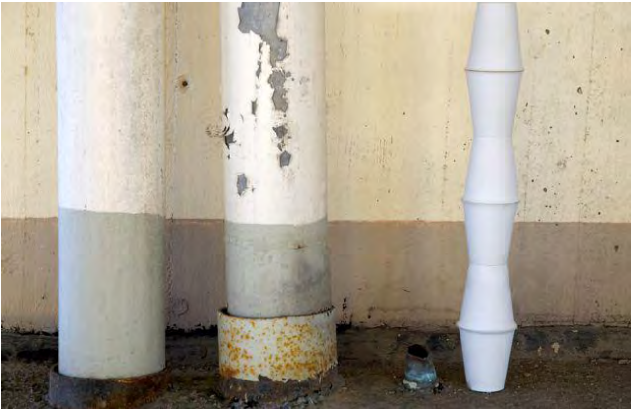
Bild 5 Koppar och rör i parkeringsgarage
